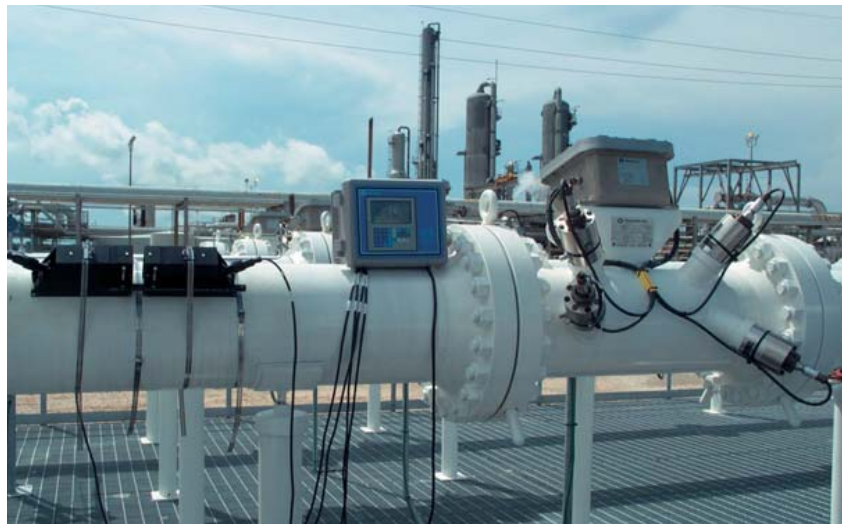
Misuratore ad ultrasuoni clamp-on per gas (sulla sinistra) a confronto con misuratore in linea di tipo intrusivo (sulla destra)
