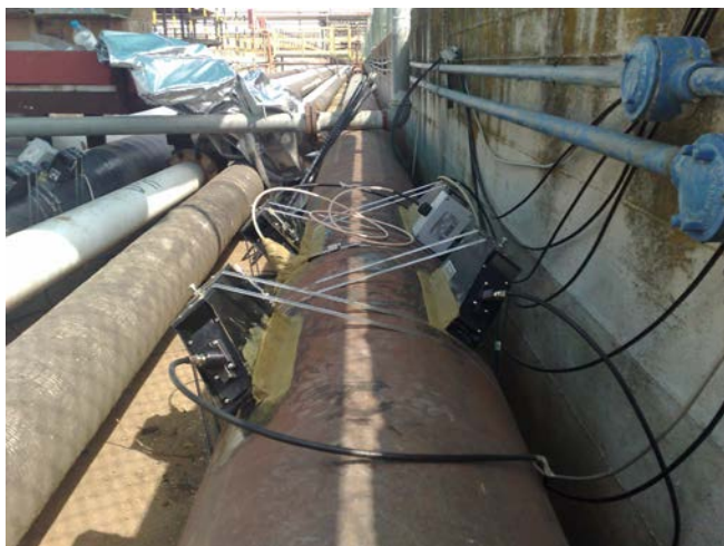
TRASDUTTORI LINEA 16" DEPOSITO
