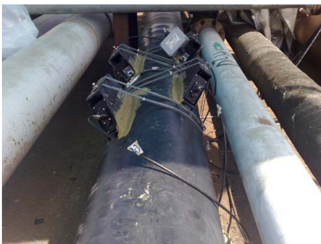
TRASDUTTORI LINEA 12" DEPOSITO
